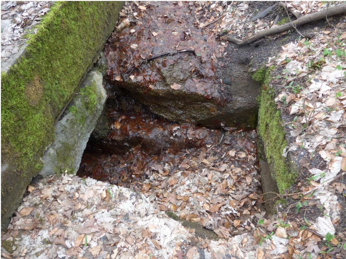
První z propustků vyžadující úpravu (levá a pravá strana)
