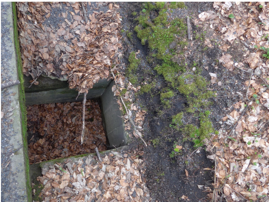
Druhý z propustků vyžadující úpravu (levá a pravá strana)
